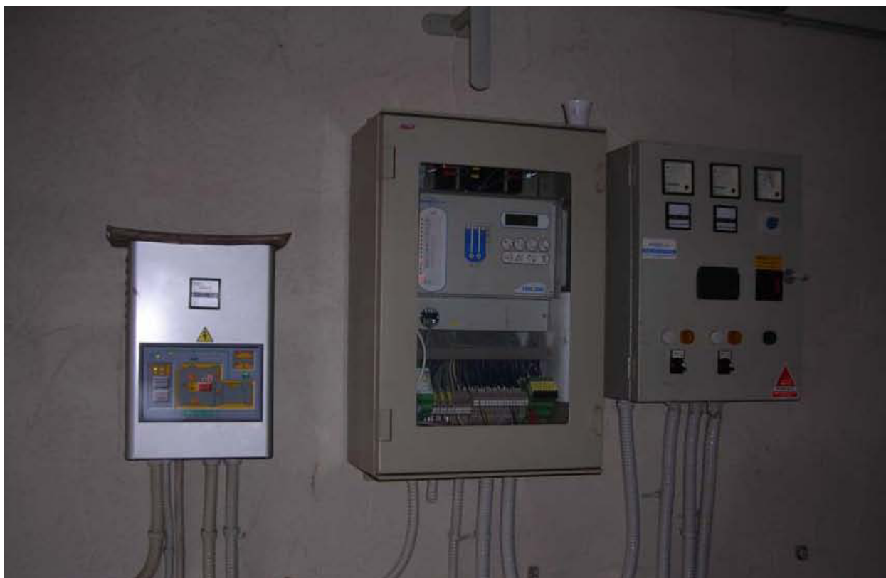
Fotografia 05 – Misuratore Enel e quadri elettrici
