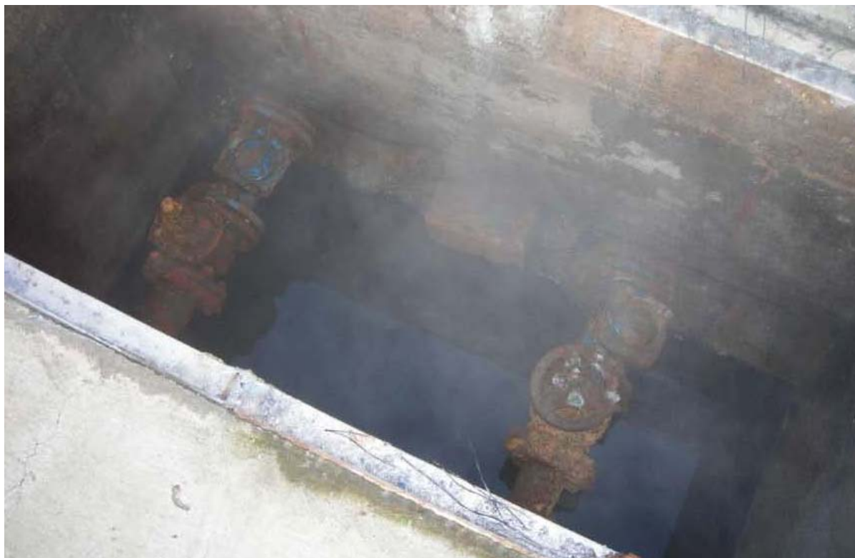
Fotografia 04 – Camera di manovra
