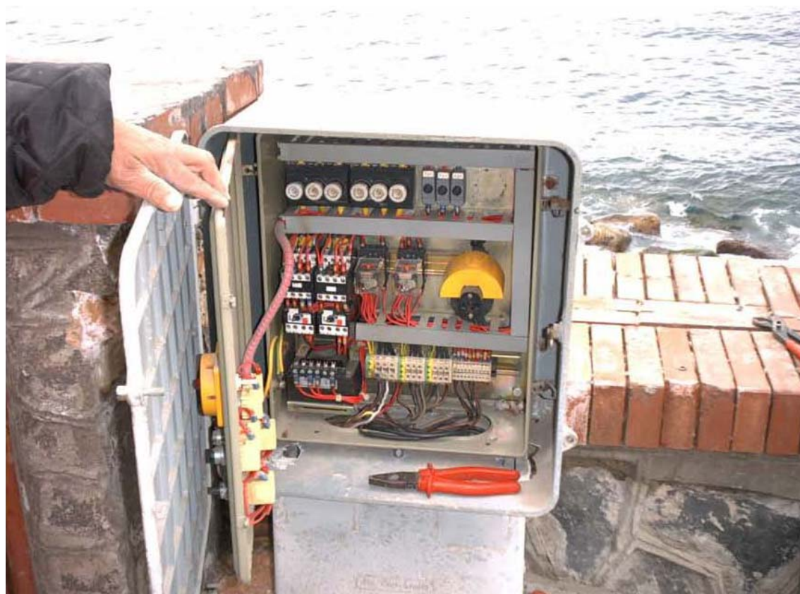
Fotografia 04 – Misuratore Enel e quadri elettrici
