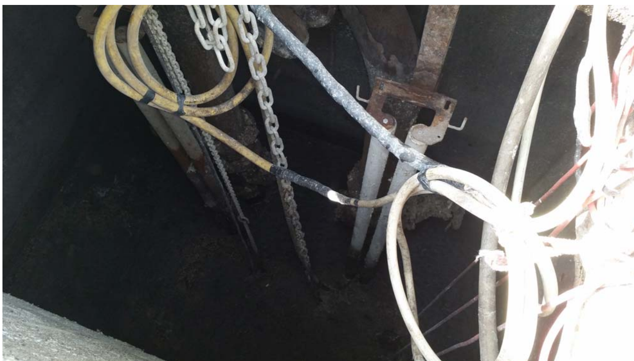
Fotografia 02 – Vasca alloggiamento elettropompe
