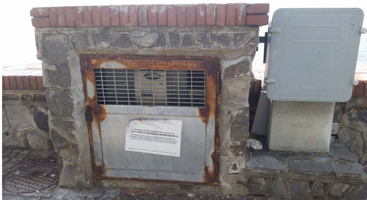
Fotografia 03 – Misuratore Enel e quadri elettrici
