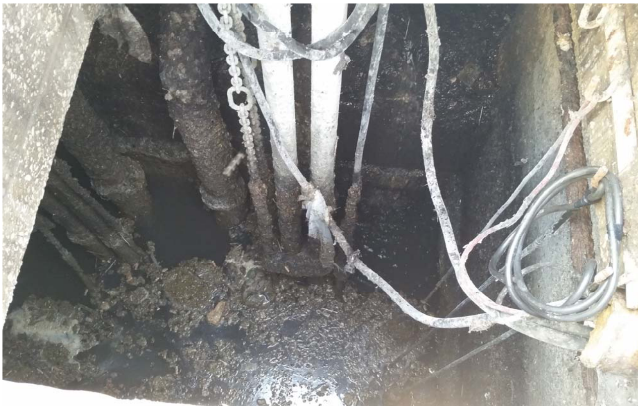
Fotografia 03 – Vasca con alloggiamento delle pompe
