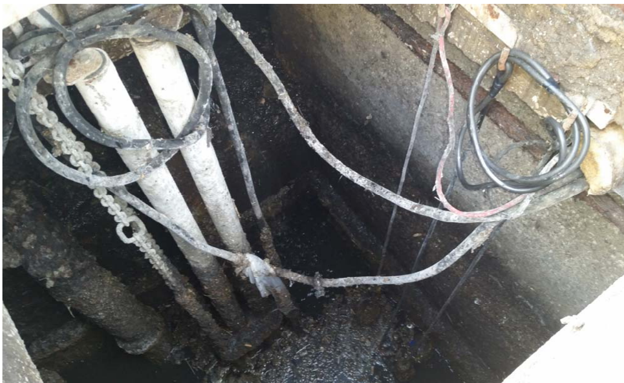
Fotografia 04 – Vasca con alloggiamento delle pompe
